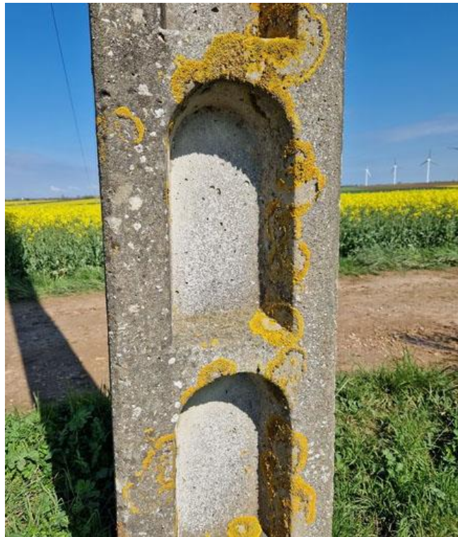
Peuplement de lichens saxicoles rudéraux sur un pylône électrique en béton
